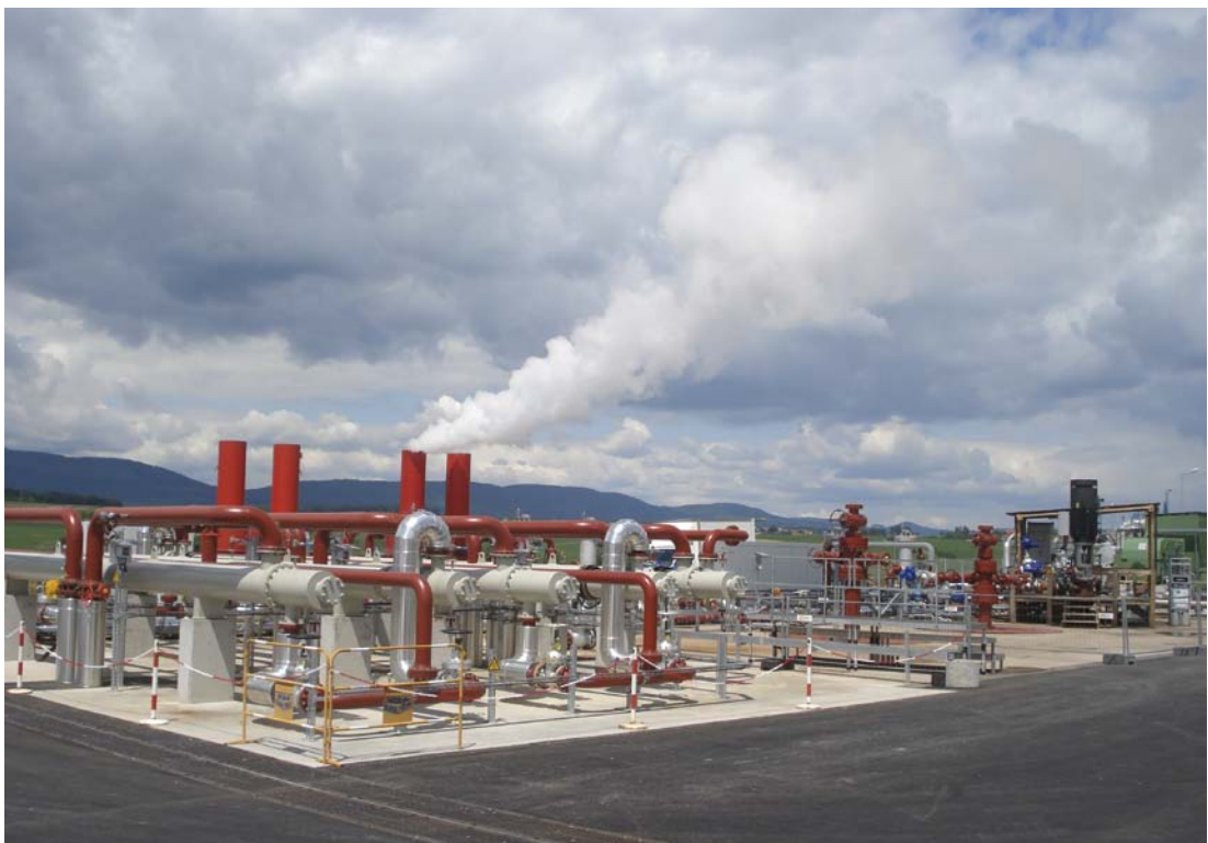
Abb. 42: Das Geothermie-Kraftwerk Soultz-sous-Forêts (Quelle: Groupement Européen d'Interêt Économique (GEIE) - Exploitation Minière de la Chaleur)
