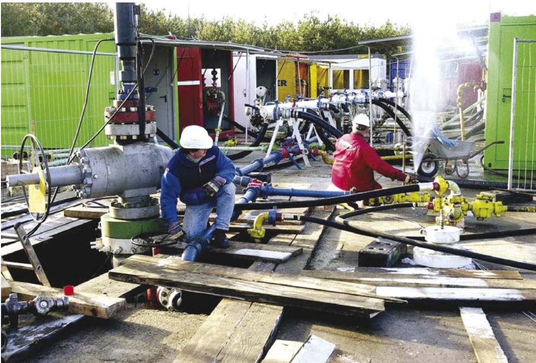
Abb. 15: Pumpenanlage beim Fractest
