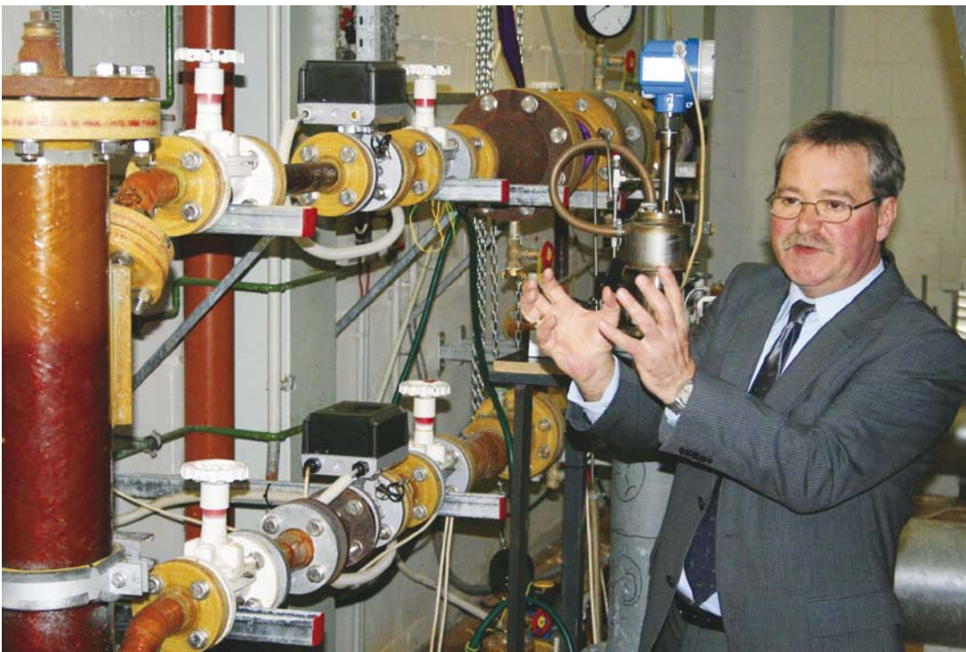
Abb. 32: In der Heizzentrale Neustadt-Glewe
