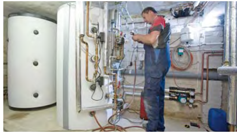
Die thermische Solaranlage auf dem Dach versorgt zwei 800-Liter-Warmwasserspeicher im Keller.
