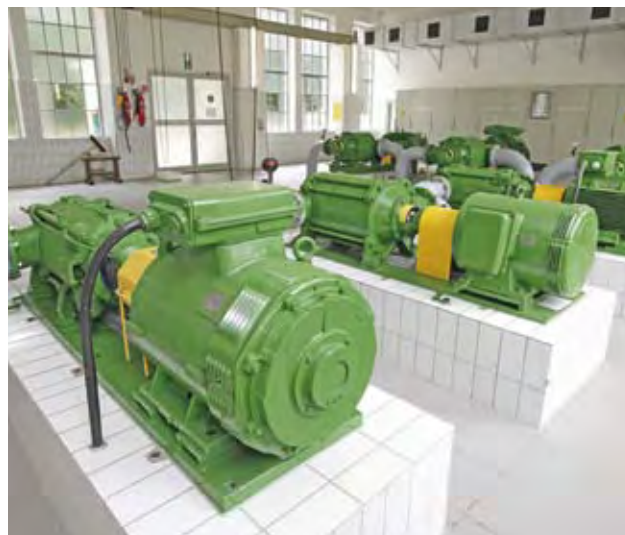
Turbinenhalle in einem Wasserkraftwerk in Bergisch-Gladbach
