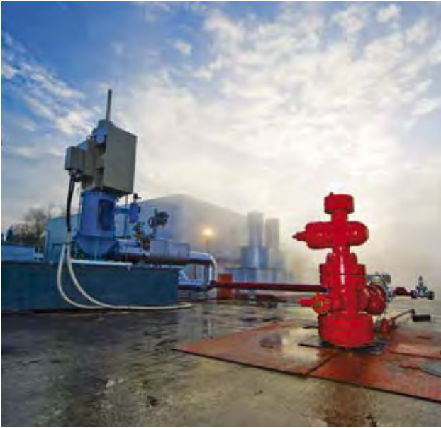
Die Abschlüsse der Bohrungen im Geothermiekraftwerk Landau
