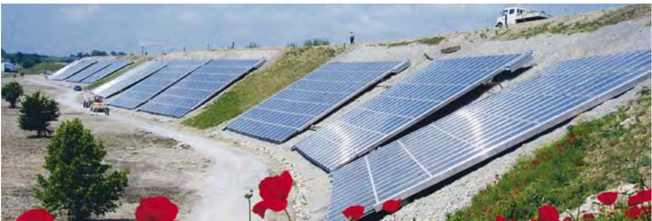
Im Leuchtturmprojekt „Solare Nahwärmeversorgung mit Langzeitspeicher“ der Stadtwerke Crailsheim wurden insgesamt 5.000 m 2 Kollektorfläche auf einem ökologischen Lärmschutzwall installiert.
