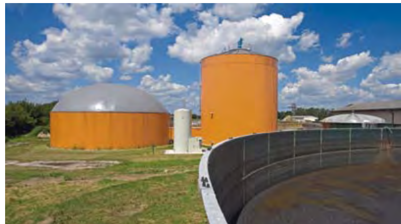
Biogasanlage: Auf der Basis von Rindergülle, Mais-Silage und Roggen wird eine Leistung von 500 kWel erzeugt.
