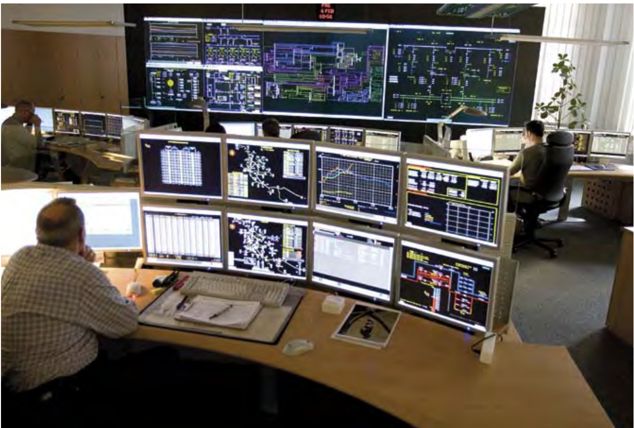
In einer modernen Leitwarte werden Kraftwerke und Verbraucher aufeinander abgestimmt.
