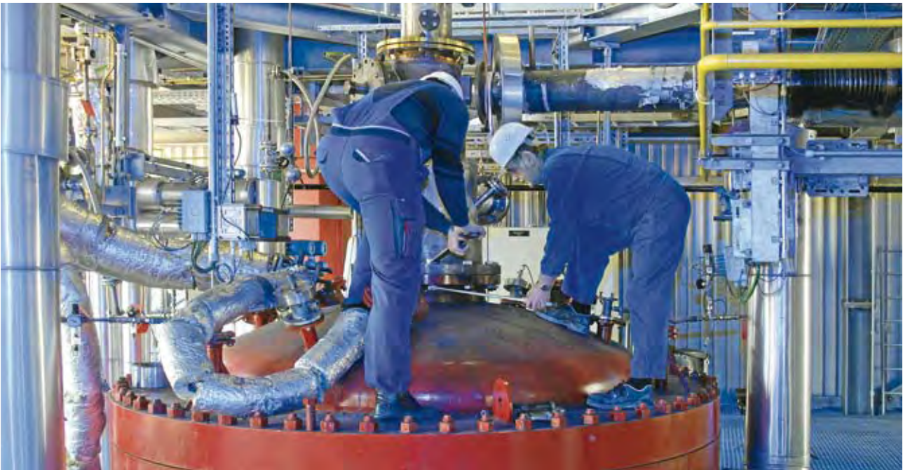
Wartungsarbeiten an einer Anlage zur Herstellung von synthetischem Biokraftstoff der zweiten Generation. Beim Herstellungsverfahren wird durch das Vergasen einer Biomasse aus Holzhackschnitzeln unter Hochdruck Biodiesel gewonnen.
