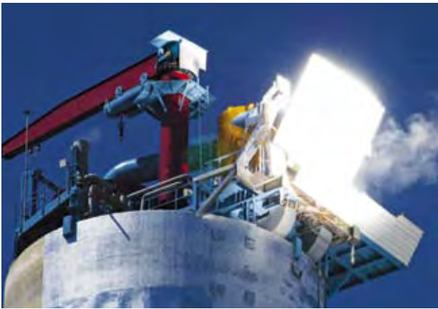
Receiver und Anlagentechnik auf der Turmspitze im Betrieb
