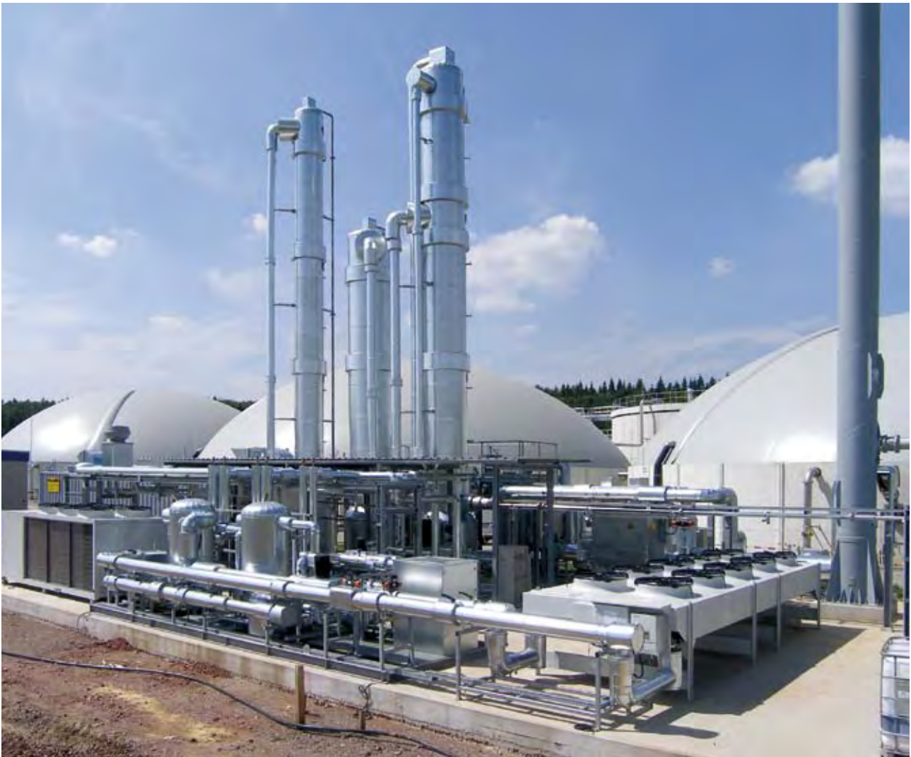
In dieser Biogasaufbereitungsanlage in Merzig wird Biogas gereinigt und in das Erdgasnetz eingespeist.
