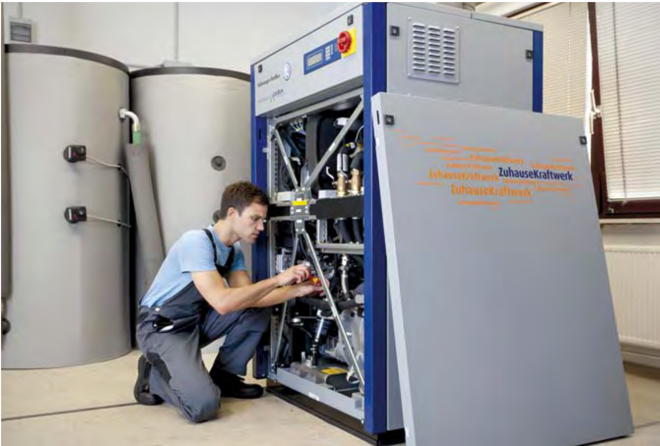
Kleine Blockheizkraftwerke können mit moderner Kommunikationstechnik zu „virtuellen Kraftwerken“ vernetzt werden - und damit auch zur Integration erneuerbarer Energieträger geregelt werden.
