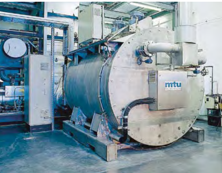
Diese Brennstoffzelle wird mit Erdgas betrieben. In der Anlage wird daraus Wasserstoff produziert und dann in den Zellen in Strom und Wärme umgewandelt.
