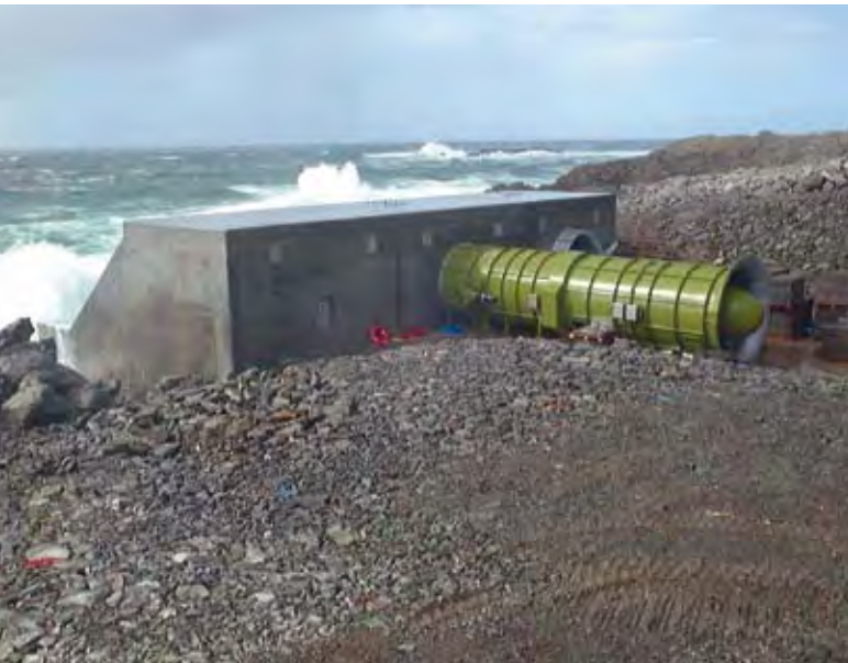
OWC-Kraftwerk mit Wells-Turbine
