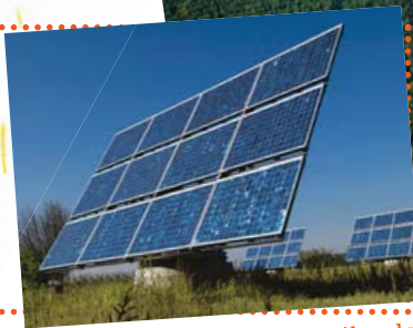
Nahaufnahme der Photovoltaikanlage
