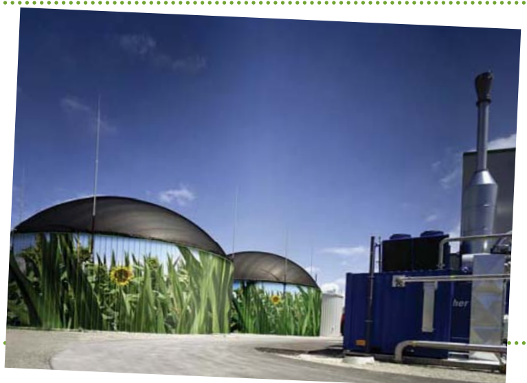
Bioreaktor (links) mit Kraftwerk (rechts)
