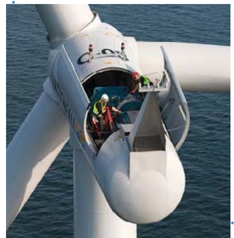
Windanlagentechniker in einer Gondel
