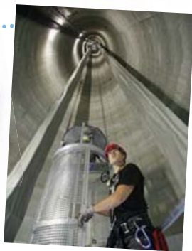
Im Turm einer Windenergieanlage
