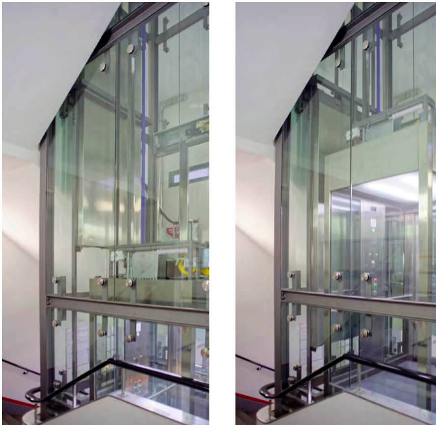
Abb. 34: Aufzug mit Gegengewicht (jeweils links im Bild)
