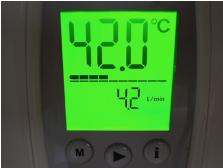
Abb. 13: Wasserstromangabe auf einem Durchlauferhitzer (HR_Ph_TF9_Volumenstrom)
