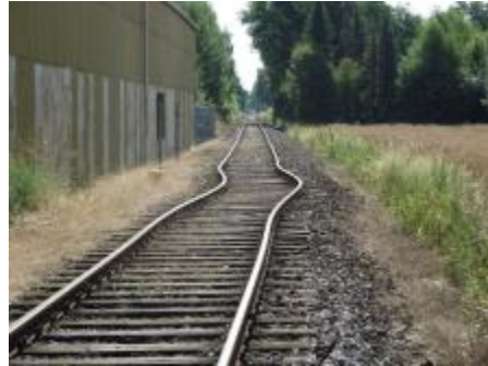
„Gleisverwerfung ehem Bf Gütersloh Ost 04 08 2013“ von ABproTWE - Eigenes Werk. Lizenziert unter CC BY-SA 3.0 über Wikimedia Commons - http://commons.wikimedia.org/wiki/File:Gleisverwerfung_04_08_2013.jpg#mediaviewer/File:Gleisverwerfung_04_08_2013.jpg
